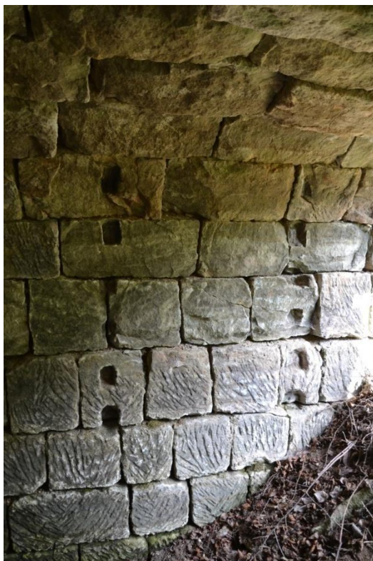
Obr. 6: Rané čp. 24 (okres Česká Lípa), sušící komora B, východní stěna s kapsami pro bidla (6 ks ve dvou sloupcích). Foto M. Kolka, 2019.
